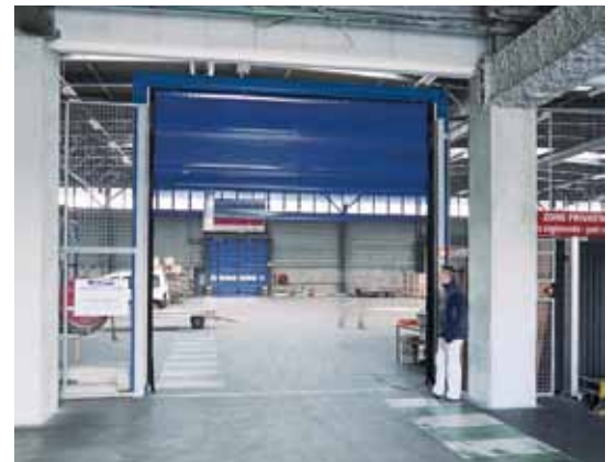
Porte souple rapide automatique, hangar, LYS
